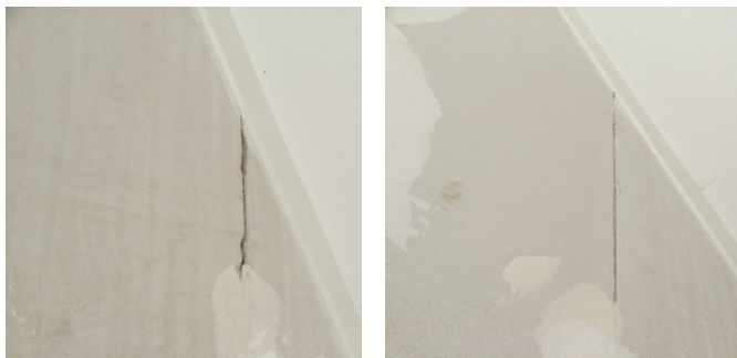
Trappgat muur cv ruimte niet behangklaar
