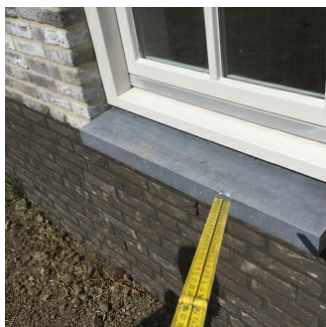
Voor gevel open stootvoegen ontbreken
