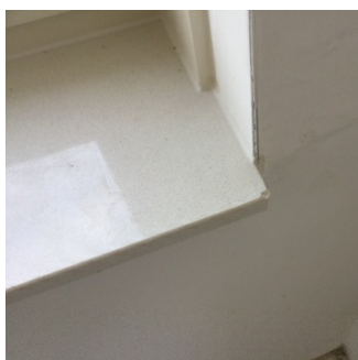
Woonkamer achtergevel beschadiging vensterbank
