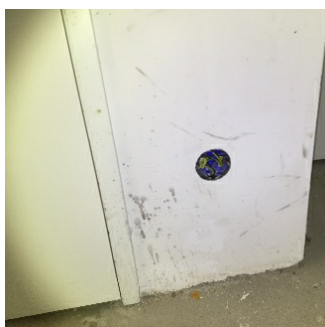
Hal schakelmateriaal ontbreekt
