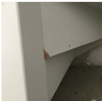
Stootbord onder trap beschadigd
