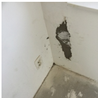
Woonkamer achter gevel stucwerk niet behangklaar
