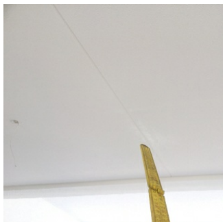
Woonkamer vlekken in spuitwerk
