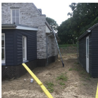
Gevelbekleding woning en schuur kleur verfwerk niet gelijk
